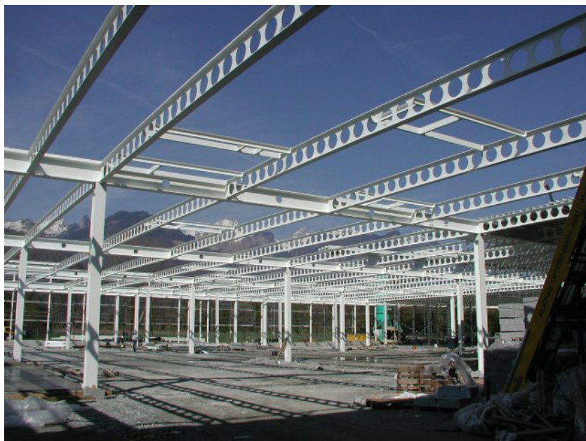
Pannes ACB de toiture
